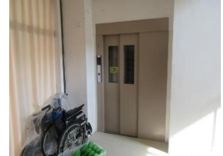
エレベーター
